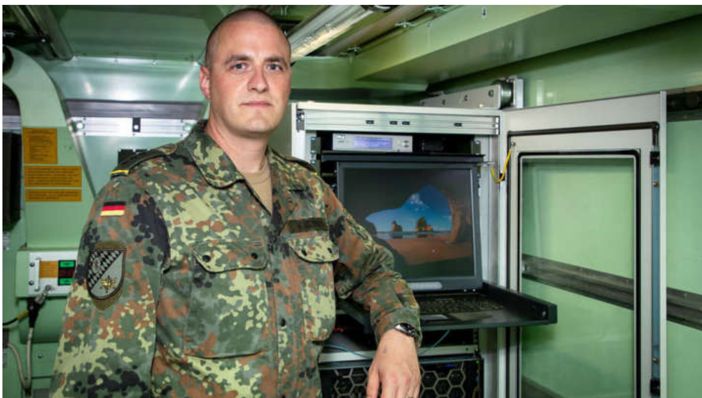
Hauptmann Stefan Würdinger und sein Team bauten eine Fernmeldekabine 2 um und installierten dort das DSÜ plus.
